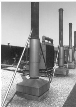
Установленные на крыше выносные радиаторы от четырех генераторных агрегатов мощностью 1000 кВА каждый и удлиненные выхлопные трубы в условиях ограничения свободного пространства и циркуляции воздуха.
