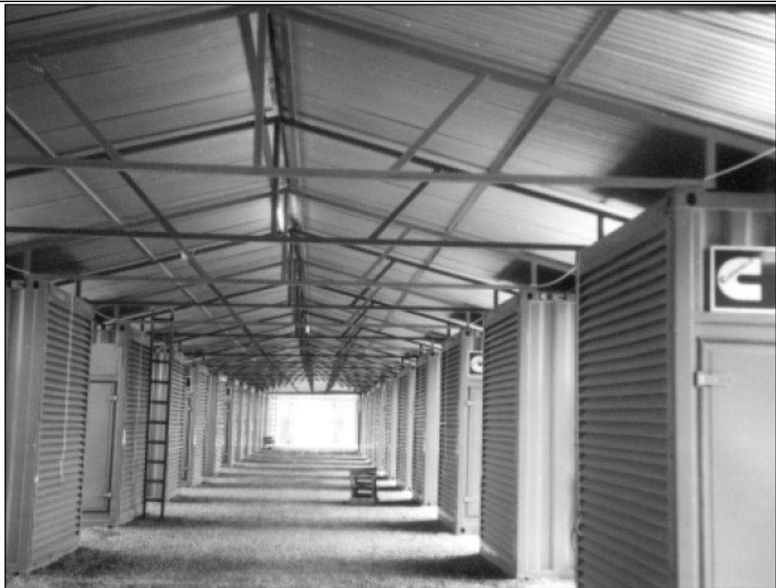
Станция из нескольких низковольтных генераторов
