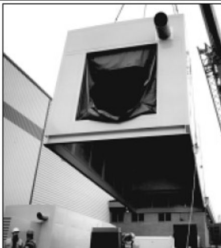
Рис. F10. Сверхмалошумный корпус для двух дежурных агрегатов по 1000 кВА каждый.
