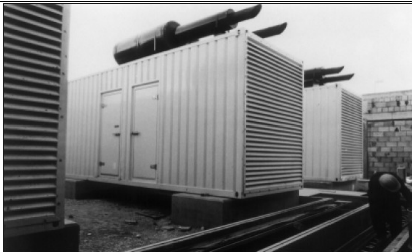
Три малошумных генератора Cummins по 1000 кВт каждый. Методика использования цементного основания устраняет необходимость укладки большой цементной плиты на всей площади установки, что позволяет экономить средства. Метод также может использоваться для установки агрегатов на крыше где иногда необходимо точечное приложение нагрузки.
